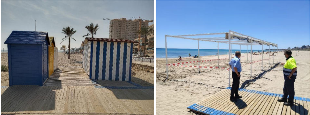
Imagen 27: Zona aseos y montaje zona de toldos en el área accesible al baño.
