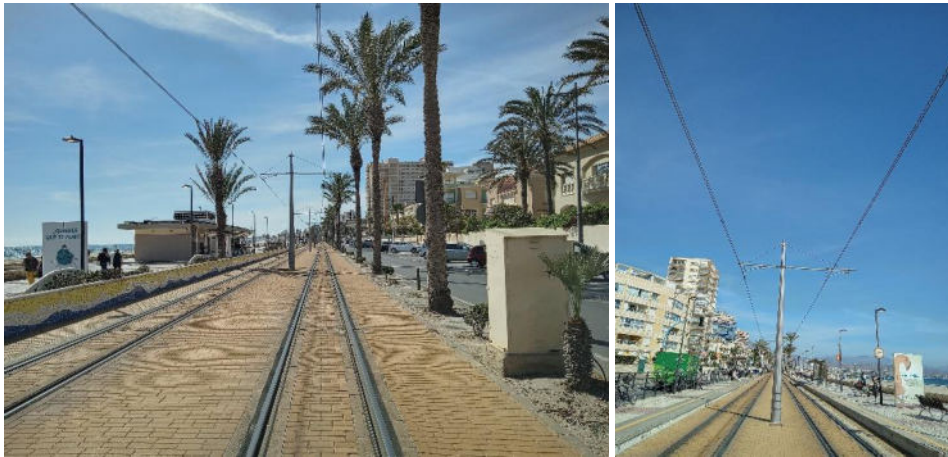
Imagen 14: Catenaria de la plataforma tranviaria TRAM.
